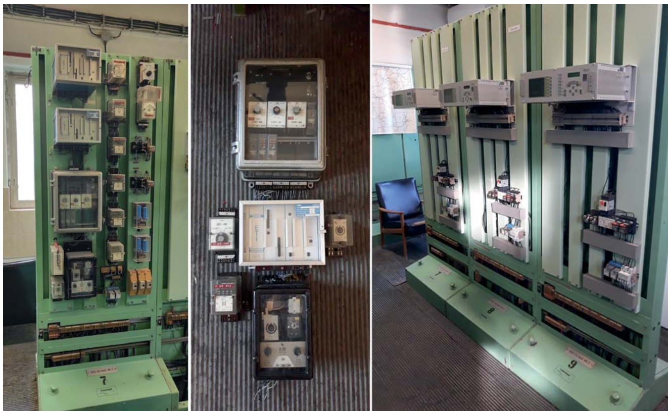
A 25 kV-os, oldali régi és új védelmi berendezések
