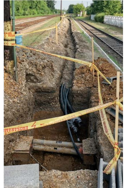
Az állomás kábelezése
