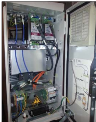
M4 METRÓVONAL WRE RÁDIÓS EGYSÉG TELEPÍTÉSE
