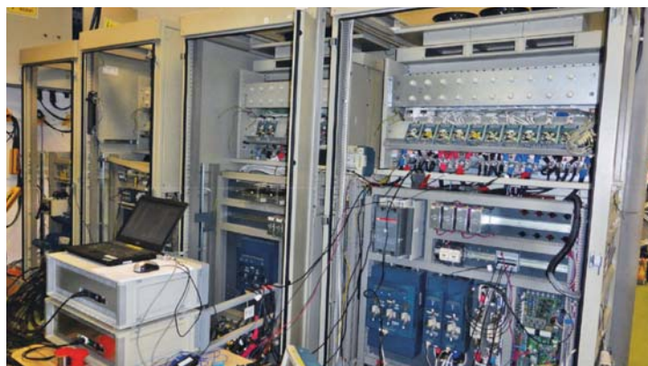
2. ábra: Nagyteljesítményű szünetmentes áramellátó rendszer szekrényei
